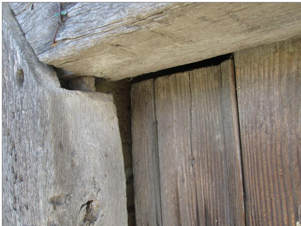
Abbildung 9: Ritzen am Scheunentor ermöglichen eingeschränkten Zugang (Foto: HPC AG, 09.07.2018)
